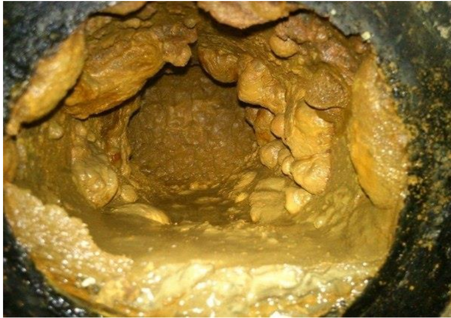
Рисунок 2 – Фрагмент сталевих водопроводу внутрішня поверхня якого деформована внаслідок процесів корозії та біологічного заростання [8].
